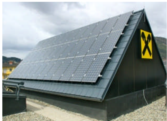
Photovoltaikanlage am Dach
